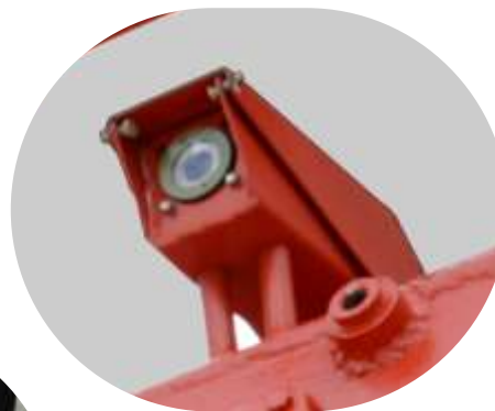
камеры системы наружного видеонаблюдения
